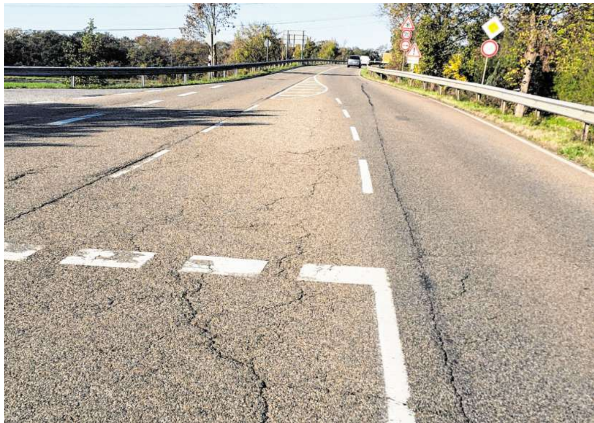
Mit vielen Rissen in der Asphaltdecke präsentiert sich die Landesstraße L 599 – hier direkt bei der Einmündung in die Bundesstraße 291 bei Schwetzingen mit Blickrichtung nach Ketsch. Nun soll der erste Abschnitt saniert werden. BILD: STRAUCH
